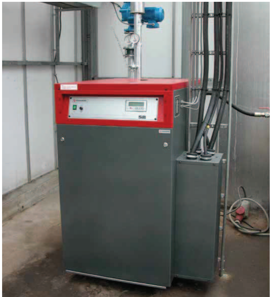
Een elektrische ketel kan nuttig zijn in perioden van overtollige stroom of negatieve stroomprijzen.
